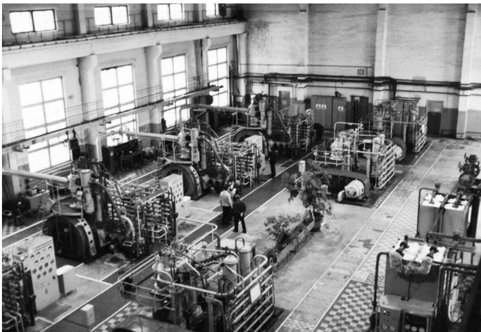
Азотный цех Отдела главного энергетика ОИЯИ. Зал компрессоров
